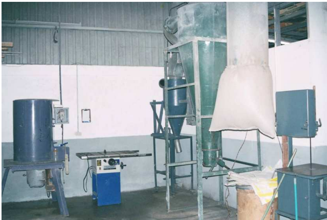
Foto 42 – Máquinas instaladas para el proceso de reciclaje
